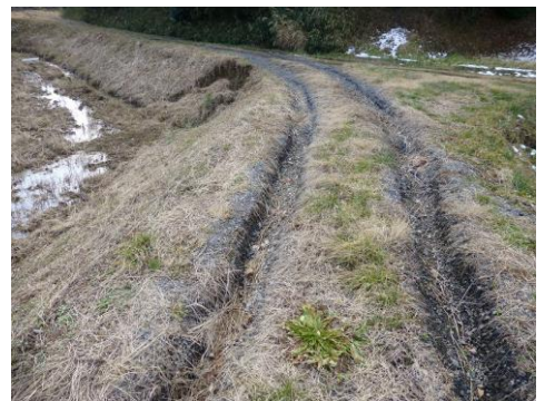
農道 (被災状況)
