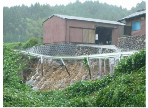
市道平海野線 (被災状況)
